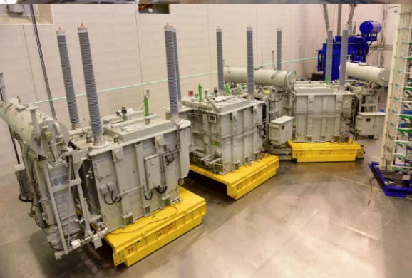
Автотрансформаторы 100 МВА 345/138 кВ и 133 МВА 345/230 кВ (источник: A2-304, E. Schweiger, S. Riegler, C. Ettl, M. Stössl, S. Bose, Германия, Австрия, США)
